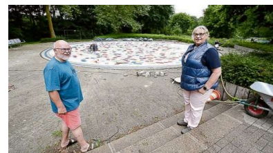
Jürgen und Dagmar Kaldeweide (Vorsitzender und Schriftführerin des Trägervereins Freibad Hüls e.V.) sehen, dass die Bauarbeiten am neuen Planschbecken auf der Zielgeraden sind. FOTO HOLZ
